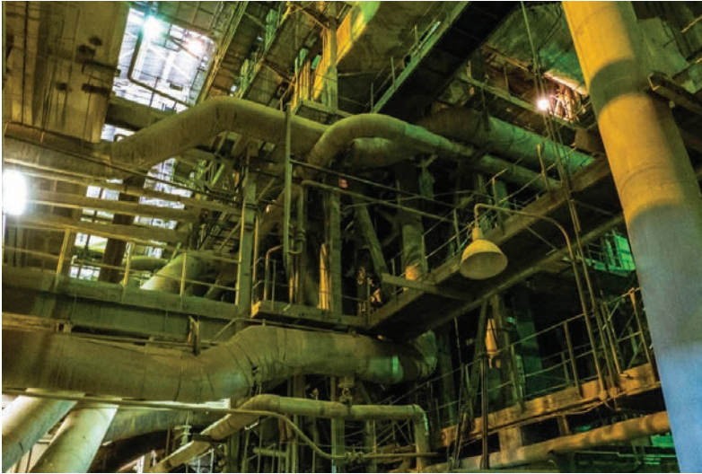
Pilt 2. Elektriijaama katel on ligi 50 meetri kõrgune torude sasipundar. Mastak 2022 ( https://stena.ee/users/mastak ).
